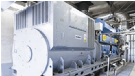
FIGURA 18: Grupo motor alternador de uma central de cogeração (fonte: MAN)
