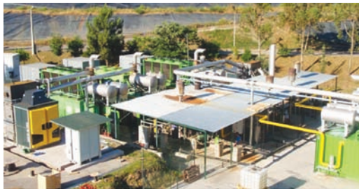
FIGURA 19: Central termoe elétrica do aterro sanitário de Sermonde (fonte: Tri-O-Gen / Sotecnisol)
