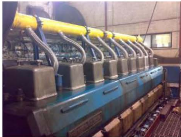
FIGURA 23 - ASPECTO GERAL DA MONTAGEM DO COLECTOR COMUM E RESPECTIVAS VÁLVULAS DE INJEÇÃO DE GÁS MONTADAS NOS COLECTORES NUM MOTOR DE 9 CILINDROS EM LINHA WARTSILA 32.
