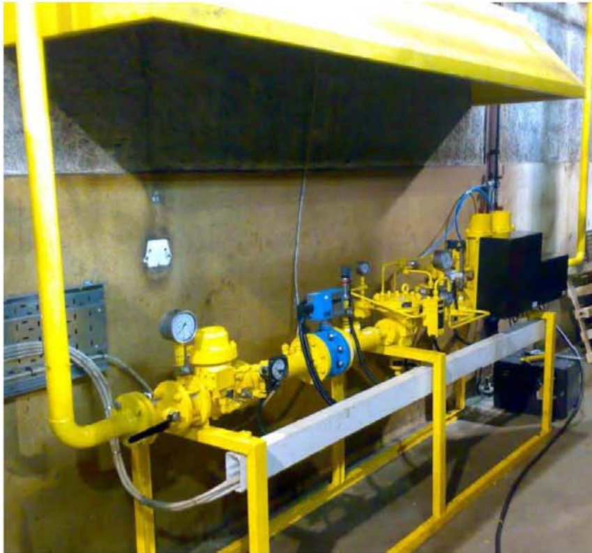
FIGURA 17 - VISTA GERAL DE UMA ESTAÇÃO DE REGULAÇÃO DE GÁS PARA UM SISTEMA DE INJEÇÃO DE GÁS MULTIPONTO JUNTO DAS VÁLVULAS DE ADMISSÃO.
