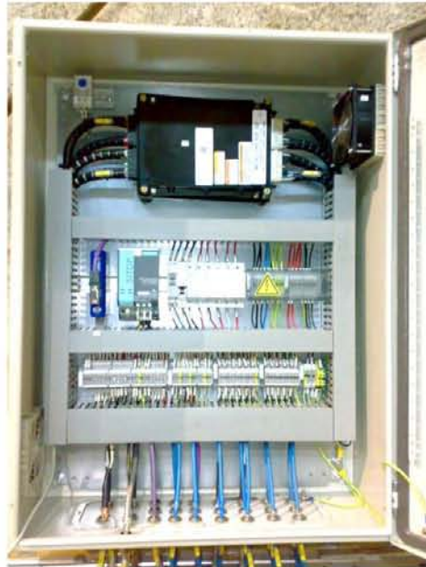
FIGURA 31 - VISTA DO QUADRO DO CONTROLADOR DE INJEÇÃO IMPULSE II E RESPECTIVA INTERFACE COM OS SISTEMAS KDS DE DETECÇÃO DE KNOCKING E MISFIRING, E PLC CENTRAL.
