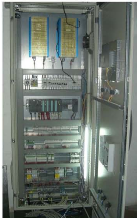
FIGURA 32 - QUADRO PRINCIPAL SISTEMA DUAL-FUEL COM ALIMENTAÇÃO DO SISTEMA, PLC PRINCIPAL E COMUNICAÇÕES.
