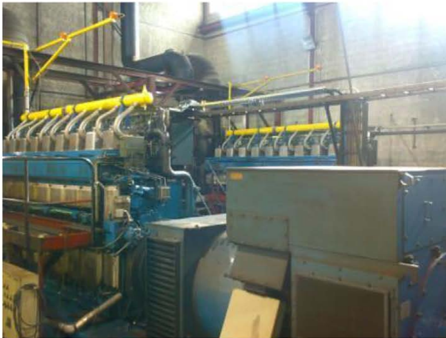
FIGURA 33 -PODE-SE VER A EXISTÊNCIA DOS DETECTORES DE GÁS NATURAL, POR CIMA DOS GRUPOS, “PONTOS COR DE LARANJA” MONTADOS EM HASTE AMARELA.
