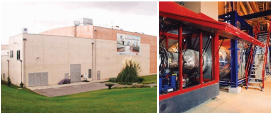
FIG.19 Central de trigeriação da Climaespaço e detalhe da turbina de gás (fonte: Climaespaço)
