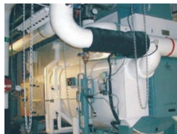
Chiller de absorção (520 kW t )
