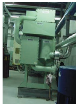
Chiller de absorção
